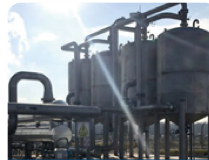
Silos con carbón activado
