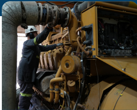
Plantas de Tratamiento de Gases y Generación de Energía
